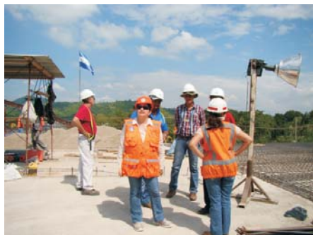
La ingeniera Carmen Padilla de InvEst – Honduras también Cuenta del Milenio – Honduras en recorrido por el tramo en construcción
